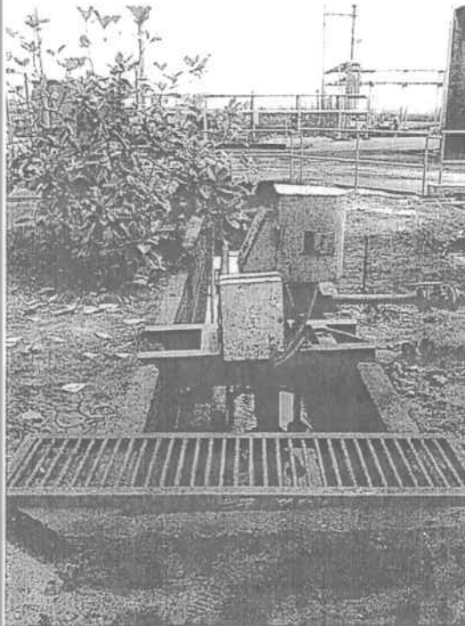
Foto 8. Bomba que conduce el agua proveniente de la planta de cogeneración hacia la PTAR.
