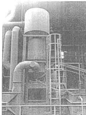
Foto 5. Lavador de gases de la planta de molienda.
