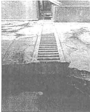
Foto 4. Canal que recolecta posibles derrames de la planta de sulfato de manganeso para retornarlos al proceso.
